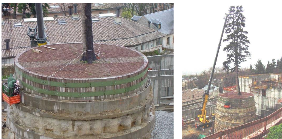
Figura 139: Medidas de protección y salvataje de abeto de 33 m de altura y 105 años, en la construcción del nuevo auditorio de San Lorenzo de El Escorial. Fuente: Gestión de Parques, Jardines y arbolado urbano (Gestión de árboles singulares: Abies pinsapo de S. Lorenzo de El Escorial) Material del curso de capacitación dictado por el Ing. Santiago Soria en San Martín de los Andes, diciembre 2003.
